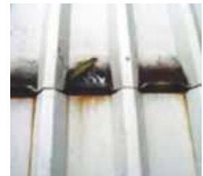
일반 아연도금강판의 설치 7년 후 절단면에 심한 부식이 발생
