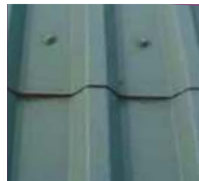
갈바로이 징크의 설치 7년 후 절단면에 부식이 없음
